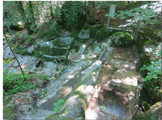
Abbildung 16: Tirolerwehr der Wasserfassung des Kraftwerks Büron (50002).
