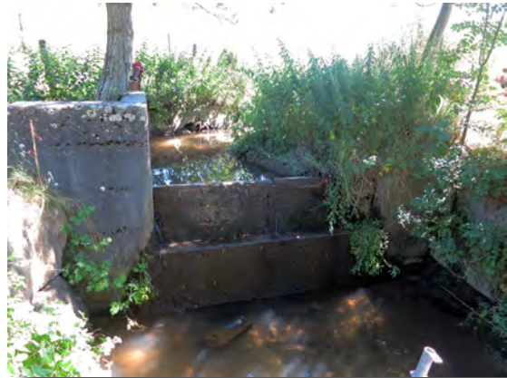
Abbildung 28: Für Fische nicht passierbare Wasserfassung des Kraftwerks Schär Holzbau (93001).
