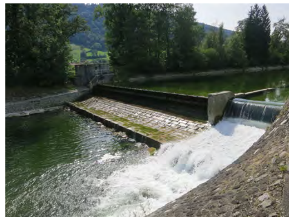
Abbildung 39: Wehranlage des Kraftwerks Thorenberg.
