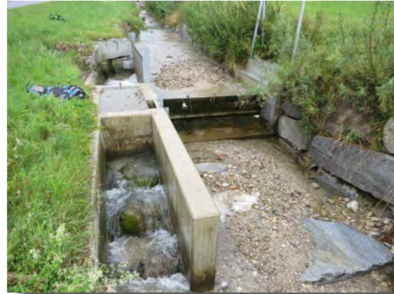
Abbildung 47: Fischeufstiegshilfe im Ballenbach bei der seitlichen Wasserentnahme des Kraftwerks Feldmoos (20011).
