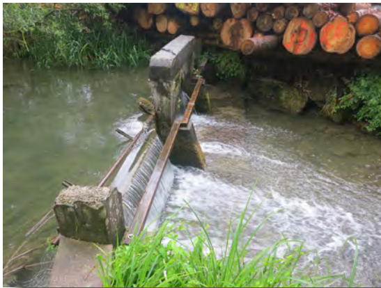
Abbildung 9: Streichwehr bei der Wasserentnahme der Sägerei (70002).
