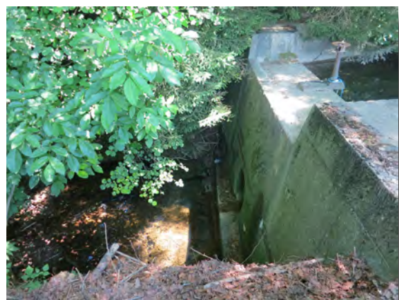
Abbildung 17: Wasserfassung des Kraftwerks Widmer Buezwil (50006) im Röllbach.
