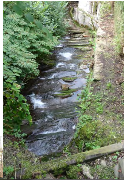
Abbildung 35: Staumauer des alten Mühleiteiches der Mühle Ebikon (10006, links), sowie natürliches Aufstiegshindernis oberhalb der Mauer (rechts).
