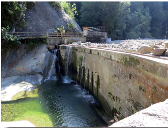
Abbildung 43: Für Fische bachaufwärts nicht überwindbare Schwelle in der Grossen Entlen bei der Wasserfassung des Kraftwerks Farbschachen (2007).
