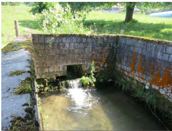
Abbildung 15: Wasserfassung des Kraftwerks Trisa (50001) im Dorfbach Triengen.
