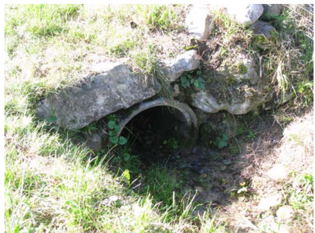
Foto 1-2: Zweiter Gewässerdurchlass des Heuschtgrabens bei der Kantonsstrasse K16
