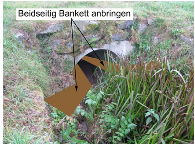
Foto 3-4: Gewässerdurchlass des Hinterreingrabens an der Kantonsstrasse K16a und der Eisenbahnlinie (Massnahme GD3)
