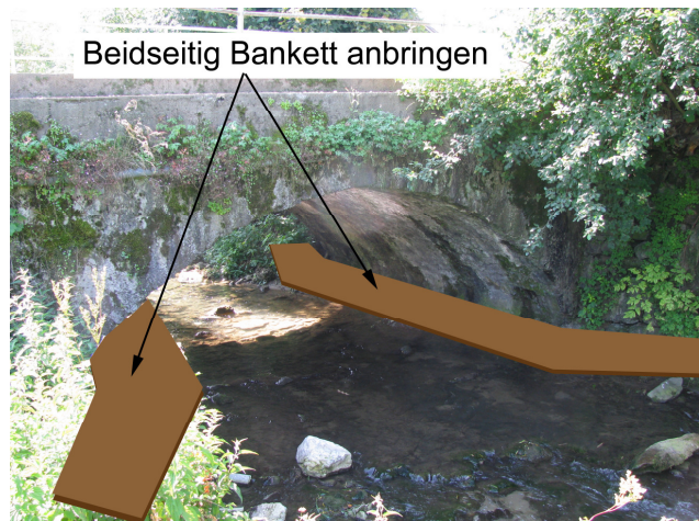
Foto 4-2: Gewässerdurchlass Wyna an der Zufahrtstrasse Winemüli (Massnahme GD2)
