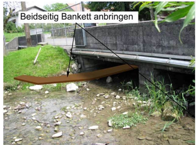
Foto 7-4: Zweiteiliger Gewässerdurchlass im „Uerdorf“ des Siedlungsgebiets Ermensee (nordöstlicher Teil: Massnahme GD4: Beidseitig Bankett anbringen)
