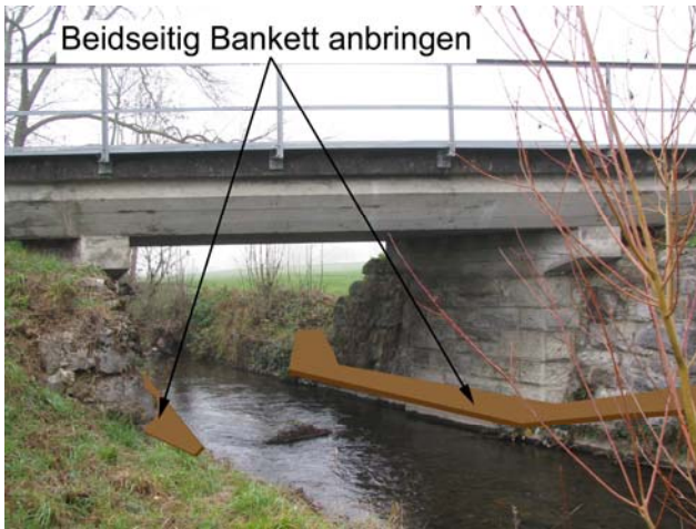
Foto 7-3: Gewässerdurchlass Aabach an der Eisenbahnlinie Mosen – Hitzkirch (Massnahme GD3)
