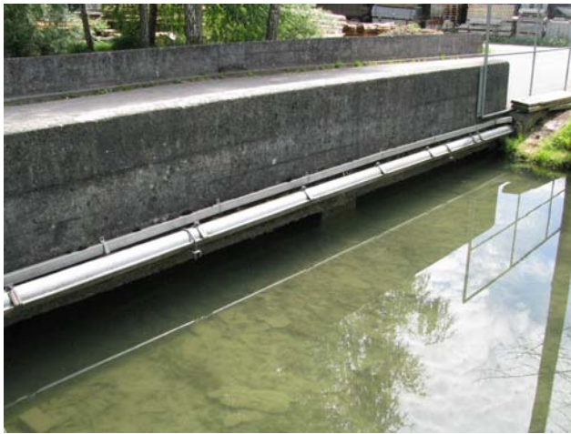
Foto 7-5: Zweiteiliger Gewässerdurchlass im „Uerdorf“ des Siedlungsgebiets Ermensee (südwestlicher Teil: Massnahme GD4: keine Massnahme möglich)
