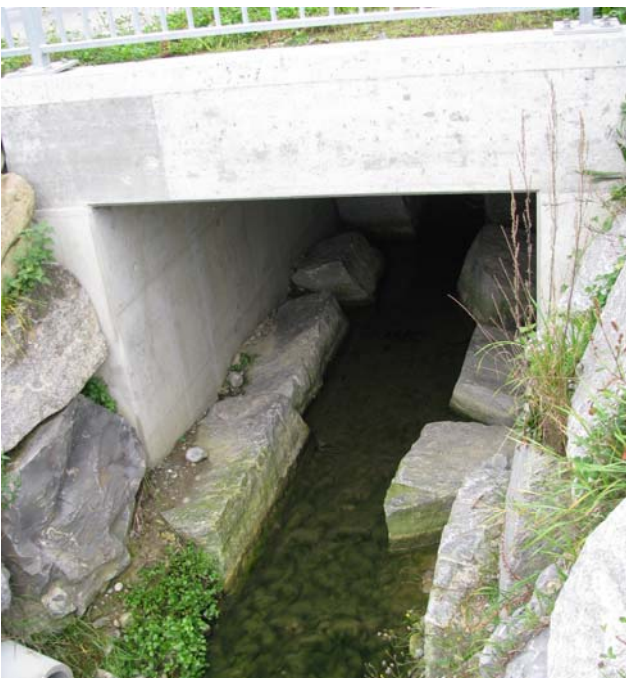
Foto 8-6: Gewässerdurchlass Birgenbach bei Kantonsstrasse K56
