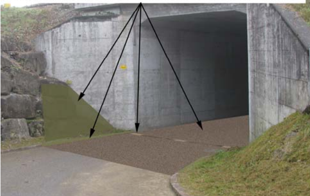
Foto 10-1: Unterführung Strässchen unter der Kantonsstrasse K16 und der Eisenbahnlinie hindurch (Massnahme UF1)
