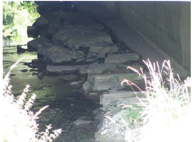
Foto 10-4: Vorhandenes Bankett beim Gewässerdurchlass Waldibach bei der Kantonsstrasse K16 und der Eisenbahnlinie
