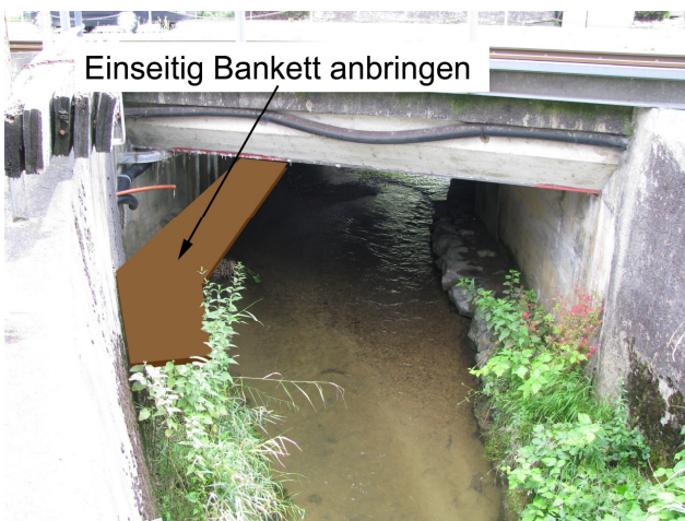
Foto 12-1: Gewässerdurchlass Stägbach an der Kantonsstrasse K16 und der Eisenbahnlinie SBB (Massnahme GD1)
