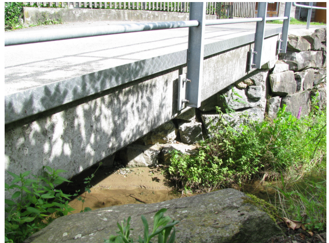
Foto 12-4: Gewässerdurchlass Stägbach im Siedlungsgebiet Baldegg (Massnahme GD4: Durchlass in heutigem Zustand belassen)
