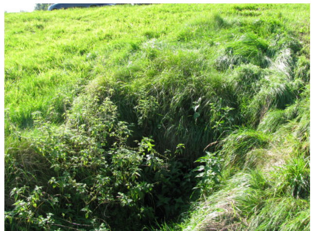
Foto 14-2: Gewässerdurchlass an der Kantonsstrasse K16 und der Eisenbahnlinie, wird in heutigem Zustand belassen, da auf anderer Strassenseite kein Gewässer mehr vorhanden ist bzw. eingedolt ist
