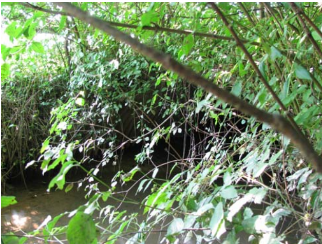
Foto 16-1: Gewässerdurchlass Seilergraben an der Kantonsstrasse K17a (Massnahme GD1: Bankett ausbessern bzw. Anbindung an Ufer schaffen)
