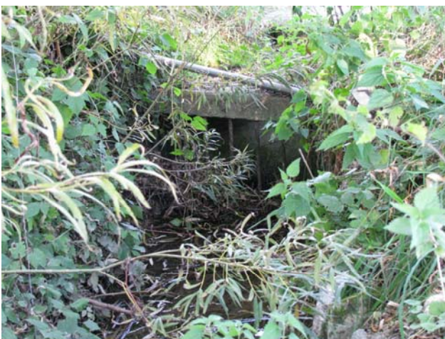
Foto 17-1: Erster Gewässerdurchlass Mühlebach an der Kantonsstrasse K56a (Massnahme GD1: Beidseitig Bankett anbringen, Gitter entfernen)
