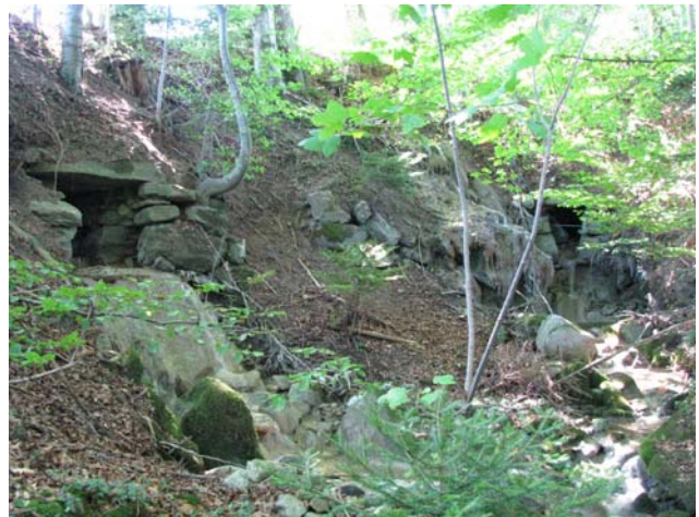
Foto 17-12: Erster und zweiter Gewässerdurchlass Mühlenbach an der Strasse Römerswil - Ermensee
