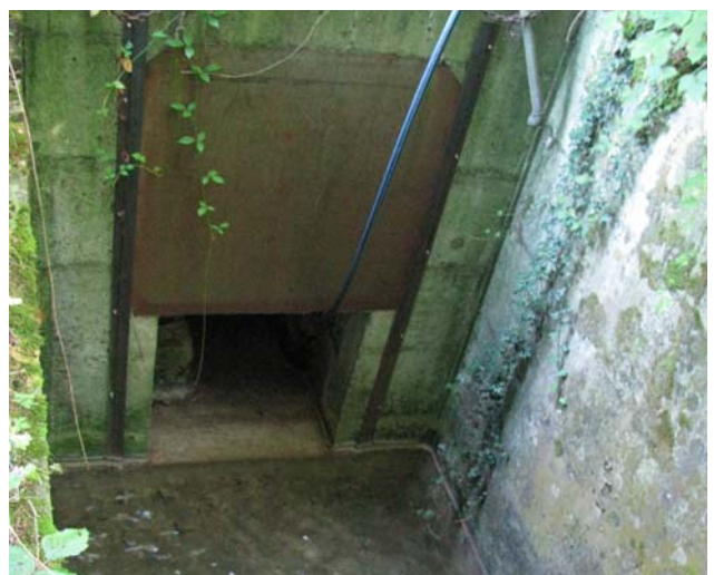
Foto 17-14: Schieber beim zweiten Gewässerdurchlass Mühlenbach an der Strasse Römerswil - Ermensee
