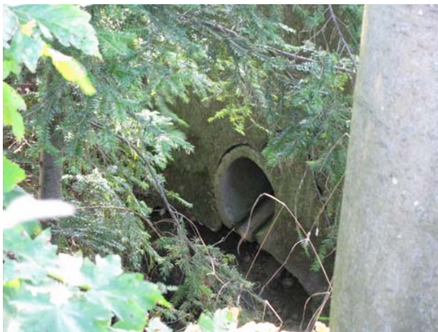
Foto 17-5: Erster Gewässerdurchlass Burgbach an der Kantonsstrasse K56a (Massnahme GD4: in heutigem Zustand belassen)
