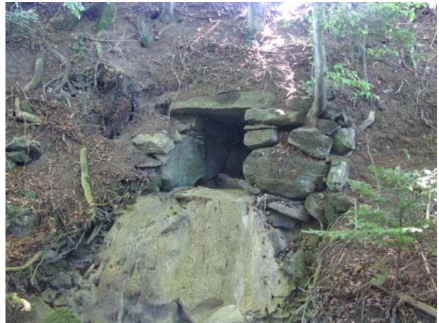
Foto 17-10: Erster Gewässerdurchlass Mühlenbach an der Strasse Römerswil - Ermensee (Massnahme GD9: Neubau des Gewässerdurchlasses inkl. Überwindbarmachung der Abstürze)
