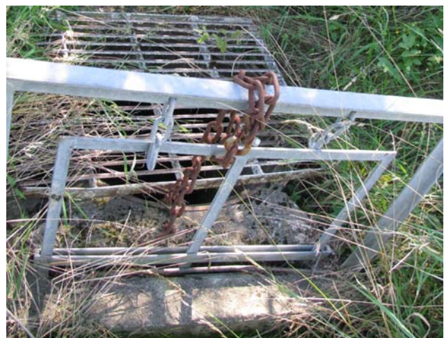
Foto 17-2: Schieber beim ersten Gewässerdurchlass Mühlebach an der Kantonsstrasse K56a
