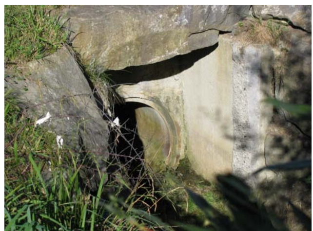
Foto 18-2: Zweiter Gewässerdurchlass unter Kantonsstrasse K15 hindurch (Massnahme GD2: in heutigem Zustand belassen)
