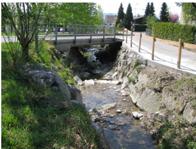
Foto 19-12: Gewässerdurchlass Lehntobelbach im Siedlungsgebiet Schenkön (Massnahme GD6: Abstürze nach Möglichkeit überwindbar machen)
