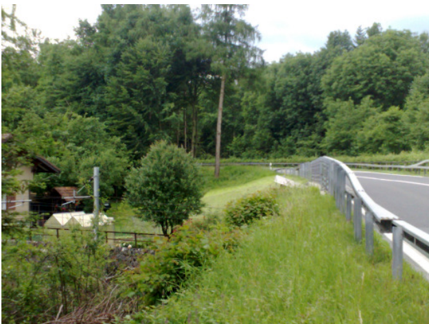
Foto 20-11: Strassenböschung im Bereich des Campingplatzes
