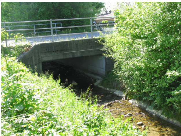
Foto 20-17: Gewässerdurchlass Chommlibach bei Strasse Sursee – Hinder-Hofstette
