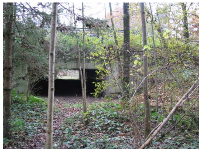
Foto 23-2: Unterführung (Wilddurchlass) unter Autobahn A2 im Chüsenrainwald, Massnahme UF2: in heutigem Zustand belassen.
