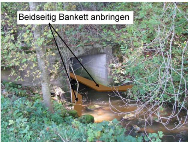
Foto 23-5: Gewässerdurchlass Kleine Aa unter Kantonsstrasse K55 bzw. Strasse Truttige-Mättwil (Massnahme GD2)
