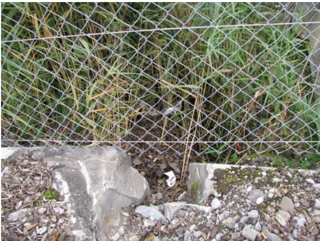
Foto 25-3: Mit losem Material zugeschütteter Gewässerdurchlass (Massnahme GD2: Zuschüttung vermeiden)
