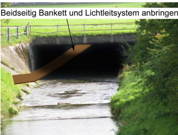
Foto 26-7: Gewässerdurchlass Rotbach unter den Pisten des Flugplatzes Emmen hindurch (Massnahme GD5)
