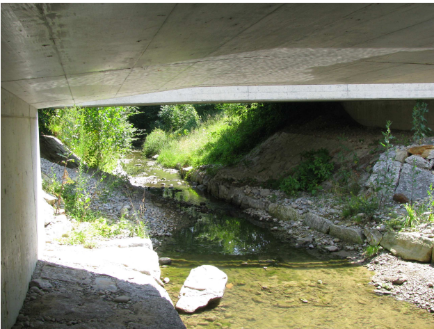
Foto 27-11: Gewässerdurchlass Buzibach (im Hintergrund) am Fussgänger- /Fahrradweg nördlich der Autobahn (Massnahme GD7: in heutigem Zustand belassen)
