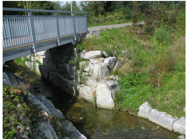
Foto 27-10: Gewässerdurchlass Buzibach am Fussgänger- /Fahrradweg südlich der Autobahn (Massnahme GD6: in heutigem Zustand belassen)
