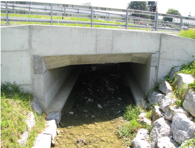
Foto 27-5: Gewässerdurchlasses Buzibach an der Autobahnauf-/abfahrt Süd (Massnahme GD2: in heutigem Zustand belassen)
