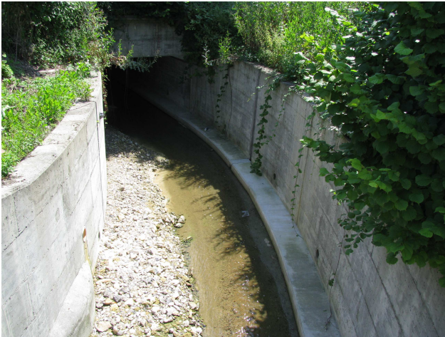
Foto 27-3: Gewässerdurchlass Buzibach an der Autobahn A2 (Massnahme GD1: Kiesbankett ergänzen)
