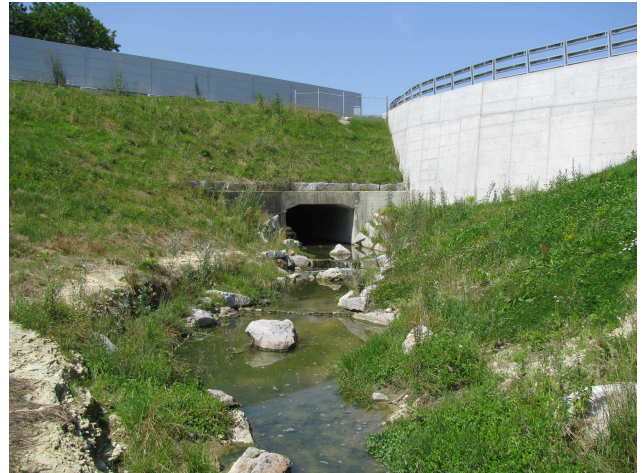
Foto 27-4: Gewässerdurchlass Buzibach an der Autobahn A2 (Massnahme GD1: Kiesbankett ergänzen)
