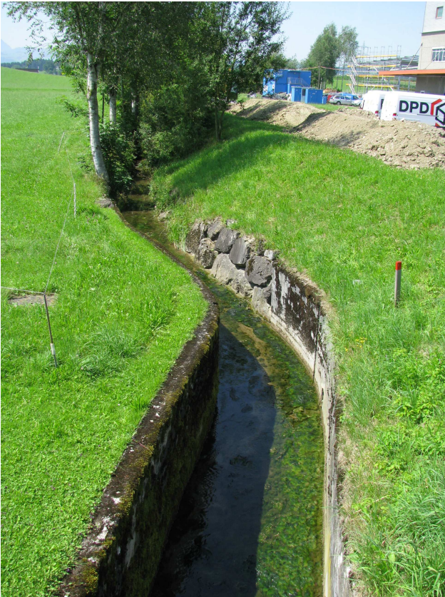
Foto 27-9: Gewässerdurchlass Buzibach an der Hasenmoosstrasse und der SBB (Massnahme GD5)
