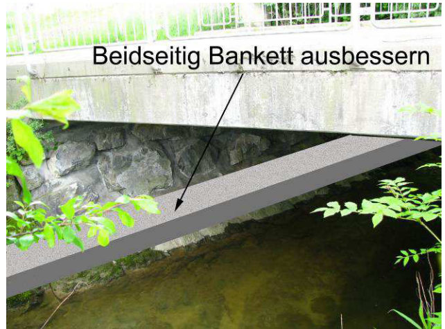
Foto 29-4: Gewässerdurchlass Rotbach an der Strasse Stächenrain – Im Spitz (Massnahme GD3)
