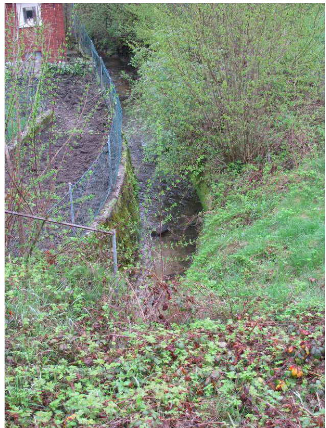
Foto 29-2: Kellenbach unterhalb des Durchlasses an der Kantonsstrasse K12
