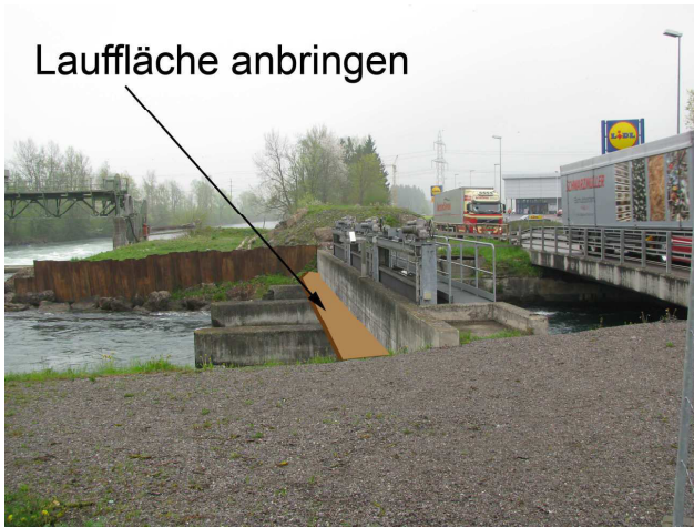
Foto 32-3: Schieber beim Kanal vom EW (Massnahme GAU1)
