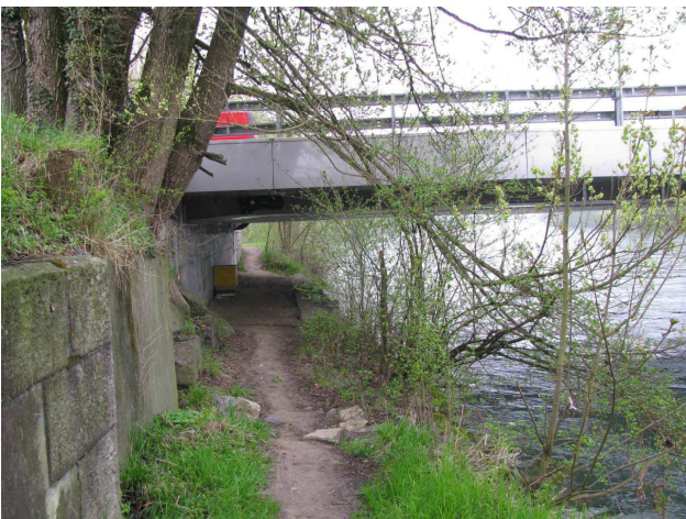
Foto 32-1: Gewässerdurchlass Reuss an der Kantonsstrasse K65 (Massnahme GD1: in heutigem Zustand belassen)
