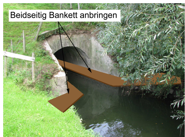
Foto 36-2: Gewässerdurchlass Ron an der Eisenbahnlinie Perlen – Gisikon-Root (Massnahme GD2)
