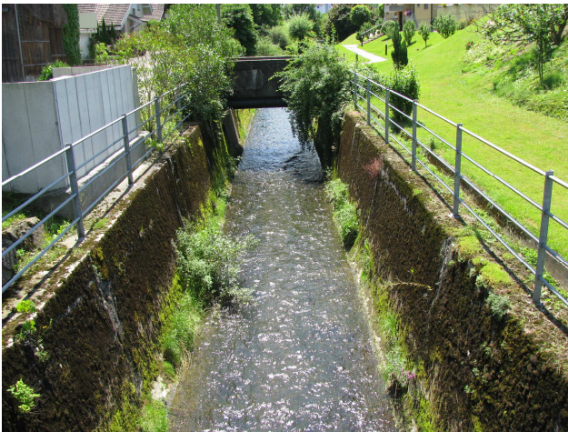
Foto 36-5: Gewässerdurchlass Ron im Siedlungsgebiet (Massnahme GD5 bzw. GAU1, auf Fotos 36-8)
