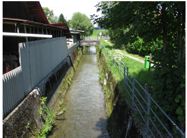
Foto 36-4: Gewässerdurchlass Ron im Siedlungsgebiet (Massnahme GD4 bzw. GAU1, auf Fotos 36-8)
