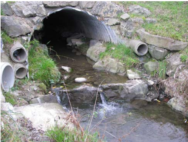
Foto 38-3: Gewässerdurchlass Charenbach unter Kantonsstrasse 17 (Massnahme GD2: Durchlass in heutigem Zustand belassen, Absturz überwindbar machen)
