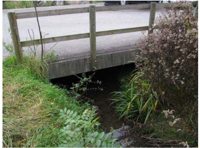
Foto 38-16: Gewässerdurchlass Wiesbach im Siedlungsgebiet (Massnahme GD9: Gewässerdurchlass in heutigem Zustand belassen)
