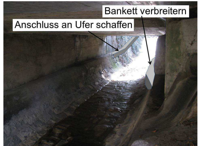
Foto 42-6: Gewässerdurchlass Rubibach an der Kantonsstrasse K2b (Massnahme GD3)
