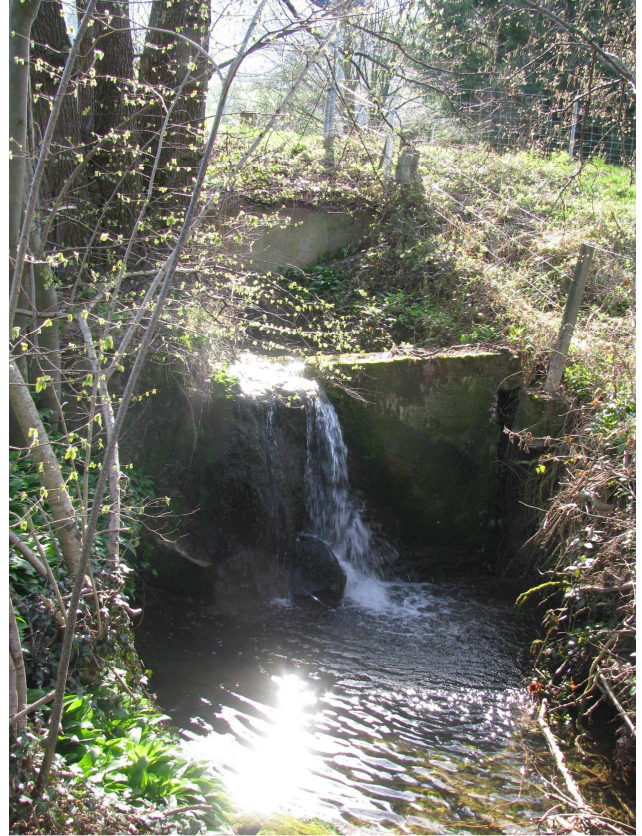
Foto 42-2: Absturz im Scheidbach unterhalb des Gewässerdurchlasses an der Kantonsstrasse K2b
