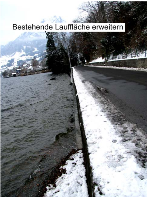
Foto 44-4: Ufermauer an der Strasse Horw - Kastanienbaum im Gebiet Sand, westlich der Villa am See (Massnahme GAU4)
