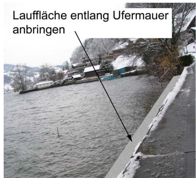
Foto 44-2: Ufermauer an der Strasse Horw - Kastanienbaum im Gebiet Spissen (Massnahme GAU3)
