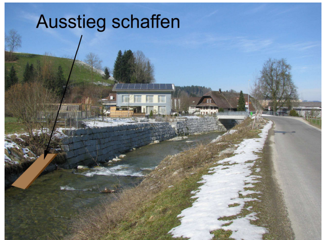
Foto 47-6: Ufermauer oberhalb des Gewässerdurchlasses GD3 (Massnahme GAU2)
