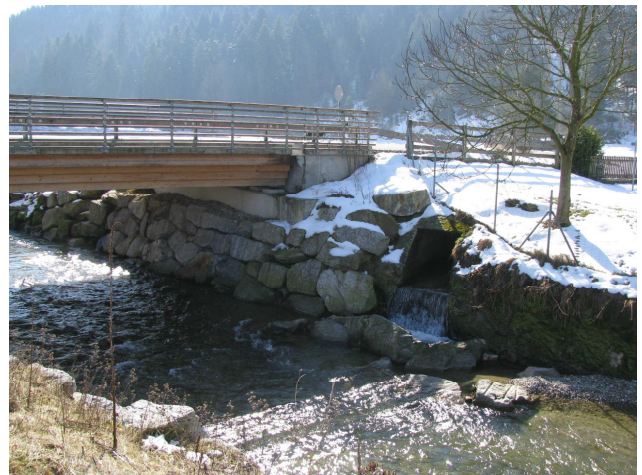
Foto 47-2: Gewässerdurchlass Luthern an der Kantonsstrasse K43a (Massnahme GD2: in heutigem Zustand belassen)
