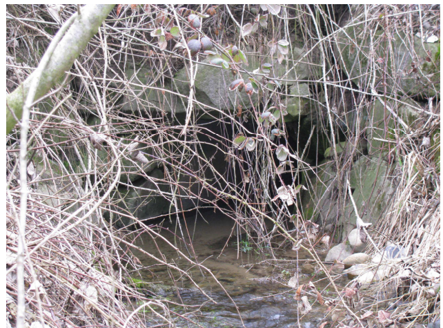
Foto 48-2: Gewässerdurchlass "Ziegeleibach" an der Kantonsstrasse K18 (Massnahme GD2: Beidseitig Bankett anbringen)
