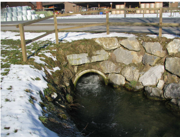
Foto 48-1: Gewässerdurchlass Mülibach an der Kantonsstrasse K18 (Massnahme GD1: in heutigem Zustand belassen)
