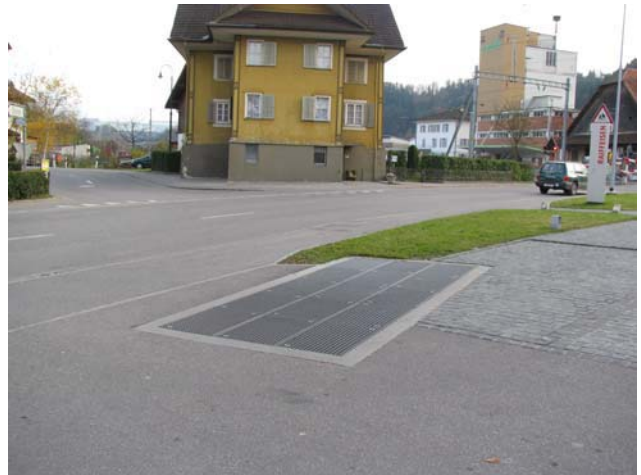
Foto 49-4: Gitterrost in Bahnhofsnähe, damit mehr Licht in den Durchlass (GD3) gelangt.
