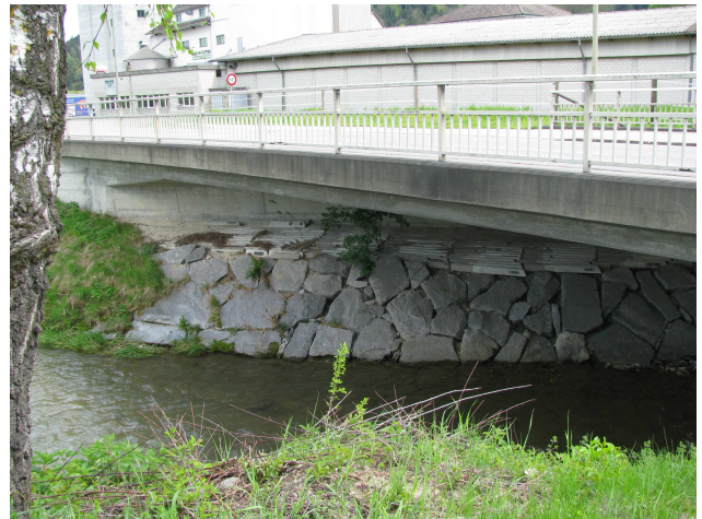
Foto 51-6: Gewässerdurchlass Wigger an der Kantonsstrasse K11 (Massnahme GD3: Strassenpfosten auf dem Bankett entfernen oder fix einbauen)
