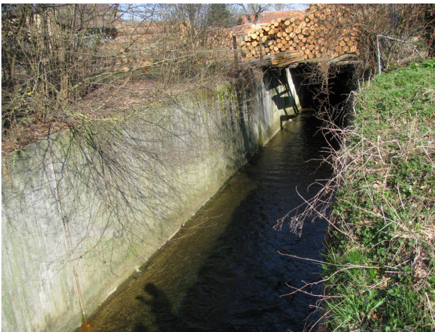
Foto 52-5: Überdeckung der Rot durch das Holzlager (Massnahme AD1: Ausdolung bzw. Entfernen der Überdeckung)
