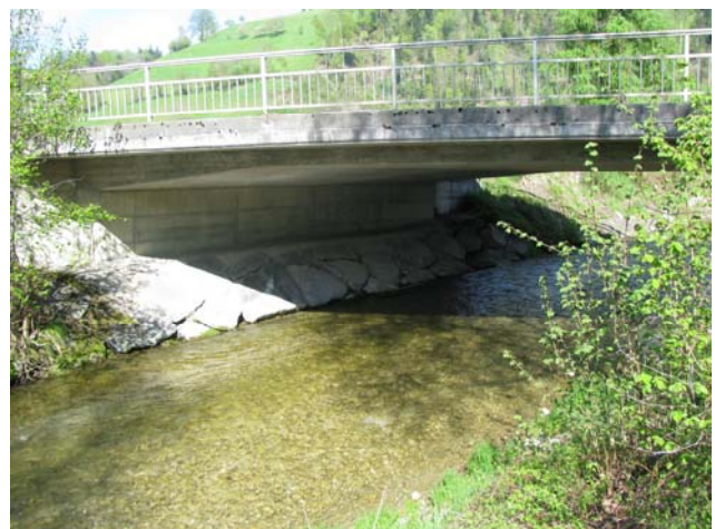
Foto 66-2: Gewässerdurchlass Luthern an der Kantonsstrasse K18 (Massnahme GD2: Durchlass in heutigem Zustand belassen)
