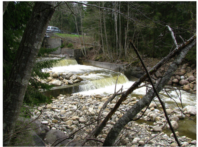
Foto 67-4: Abstürze unterhalb des Gewässerdurchlasses Rotbach an der Kantonsstrasse K36
