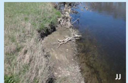
Wenn durch Ufererosion unverhältnismässiger Verlust an LN droht: Erosion im Gewässerraum ist grundsätzlich zu tolerieren. Reicht die Erosion näher als 3 m an den Rand des Gewässerraums, können in Absprache mit dem Kanton Massnahmen zur Ufersicherung getroffen werden, um Kulturlandverlust zu verhindern.
